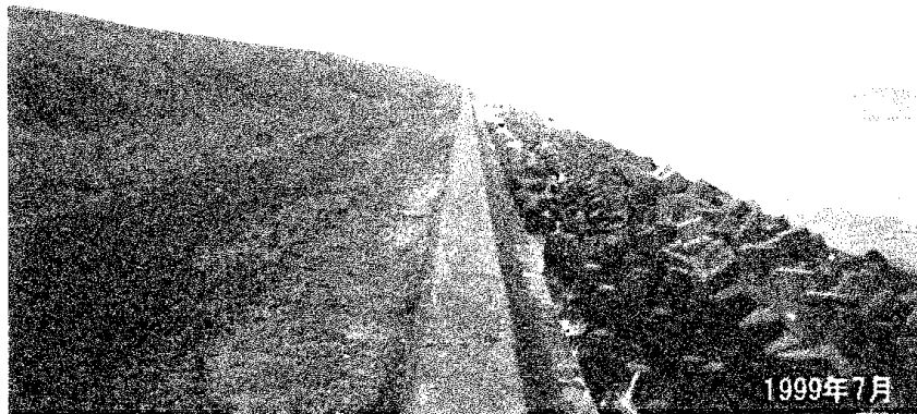
新潟県新川漁港周辺の浸食状況（地点A）
